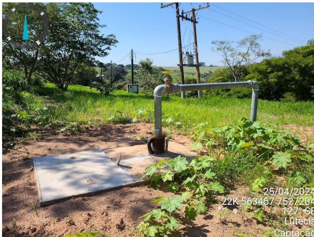
Figura 69 - Captação subterrânea de água
