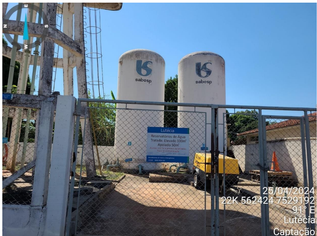
Figura 70 - Reservatórios de Água Tratada
